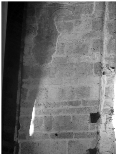
9. Трапезунд. Софийский собор. Северо-восточная предалтарная стена с началом проявления абриса окна барабана
